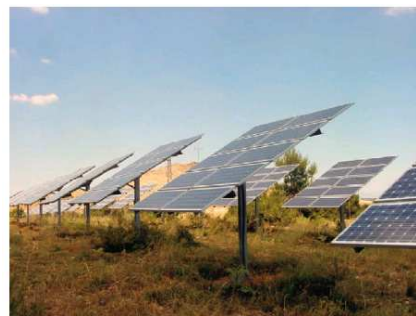
Vista parcial de la central solar fotovoltaica de Sierra María (Almería)
